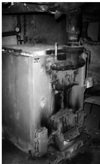
Abb. 8 Ofen im Heizungskeller 117
